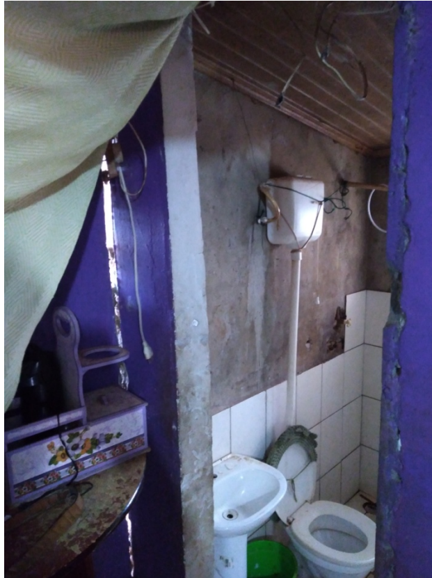
Foto 14: Marina Ferreira - Banheiro sem condições de uso
