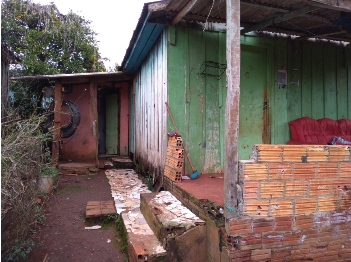
Foto 08: Priscila de Souza - Banheiro sem condições de uso - Realizado Teste de infiltração
