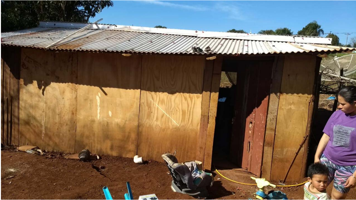
Foto 02: Juliana Crescência da Luz - Sem banheiro
