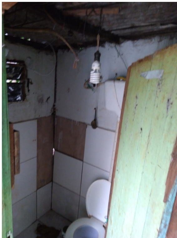
Foto 09: Priscila de Souza - Banheiro sem condições de uso
