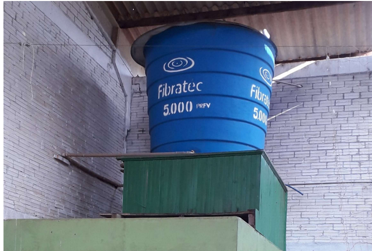
Figura 13 – Caixa de água
